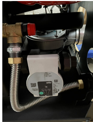
Sicherheitsventil und Ladepumpe
